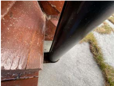
Taknedløp med frostspreng
