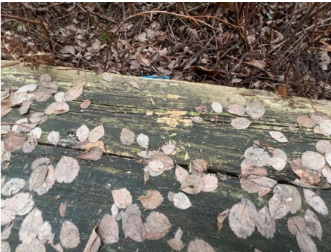
Terrassebord med råte.
