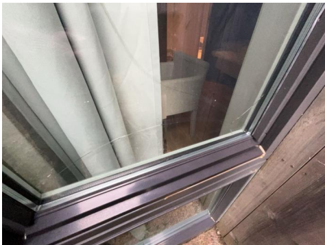
Vindu med sprekt rute.
