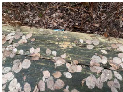
Terrassebord med råte.
