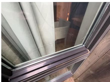
Vindu med sprekt rute.
