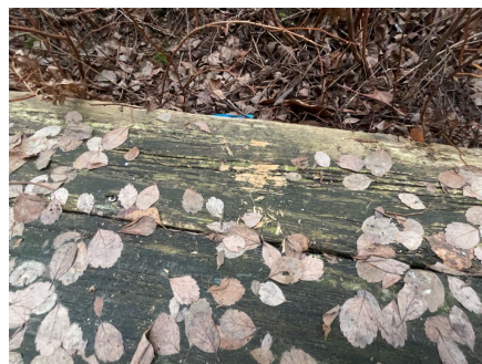
Terrassebord med råte.
