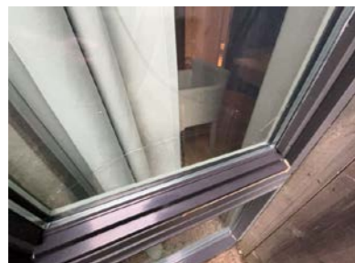
Vindu med sprekt rute.
