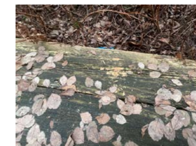
Terrassebord med råte.
