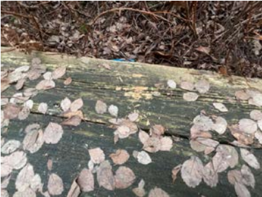
Terrassebord med råte.
