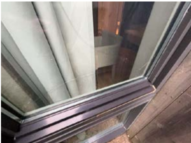
Vindu med sprekt rute.
