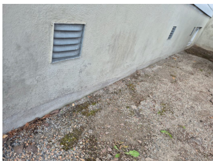
Ikke synlig vorteplast.
