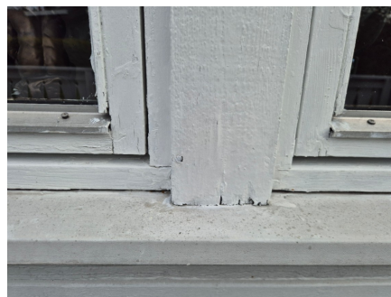
Påbegynt råte i lister.
