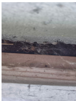
Ingen lufting i nedre del av vegg.
