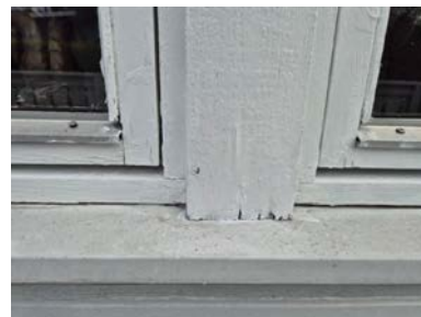
Påbegynt råte i lister.
