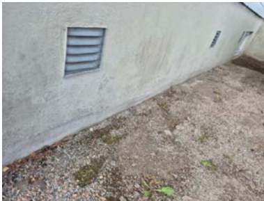
Ikke synlig vorteplast.
