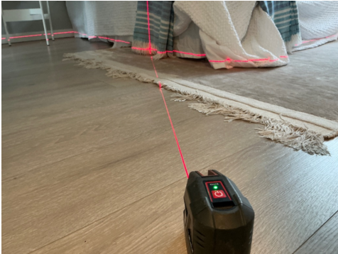
Nivellering soverom, avvik ca. 10-20 mm
