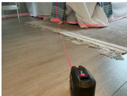
Nivellering soverom, avvik ca. 10-20 mm
