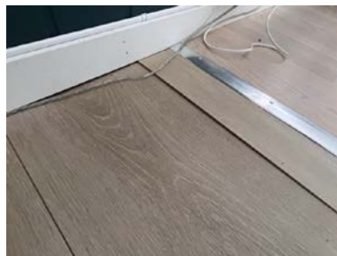
Sprekker i skjøter ved kjøkken
