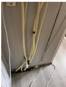
Uferdig rundt sikringsskap på 2 etasjen
