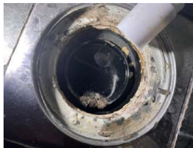
Sluk under dusjkabinett.
