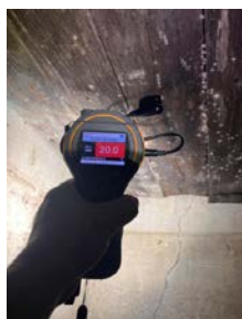
Fukt i himling, begynnende råteutvikling
