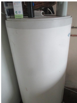
Bereder for nr: 40 er plassert på vaskerommet.
