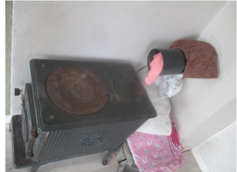
Vedovn er ikke blitt installert.
