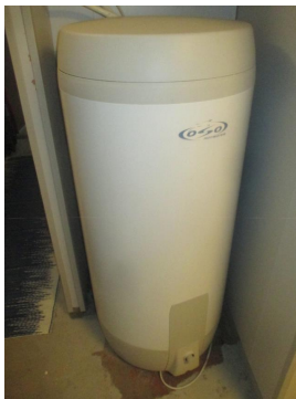
Bereder for nr: 42 er plassert på vaskerommet.
