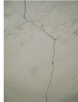
Sprekker ene ytterhjørne nr:40.
