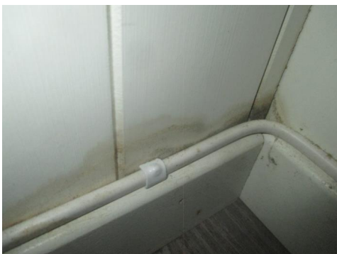
Noe fukt/kondensmerker på utfored vegg på soverom i enhet 42.
