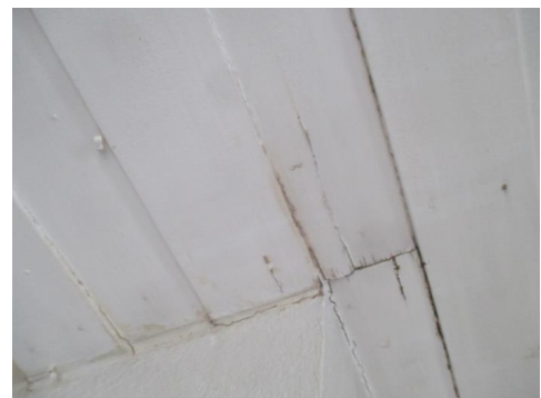
Lekkasjemerker i rundt pipe i 42.
