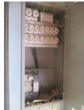
Sikringsskap for nr: 40 er plassert i vindfang.
