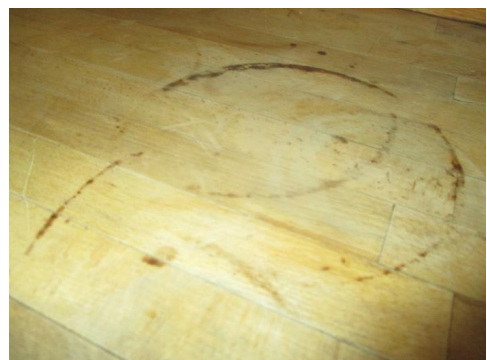
Slitasje/skader på benkeplate.
