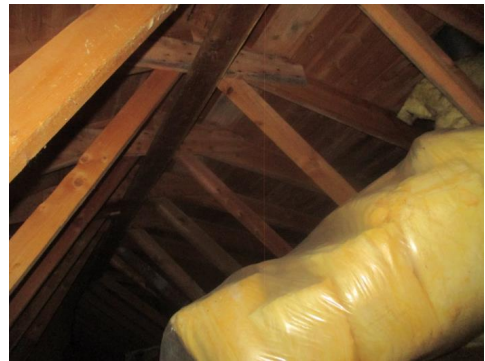
Noe fukt/kondensmerker på undertaket (nr:40)
