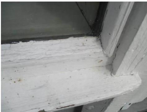
Slitasje på utvendig karm og ramme.
