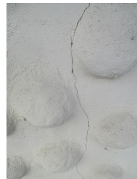
Mindre riss under enkelte vinduer.
