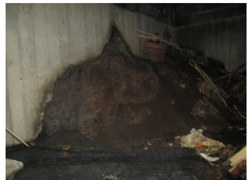
Noe innsig av fuktighet må forventes til tider.
