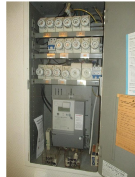
Sikringsskap for nr: 42 er plassert i gangen hovedetasjen.
