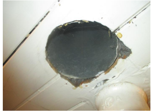
Luftekanal uten deksel.
