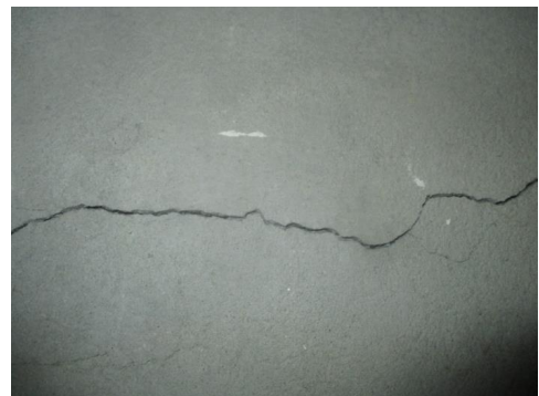
Synlig langsgående sprekk i bod i nr: 40.
