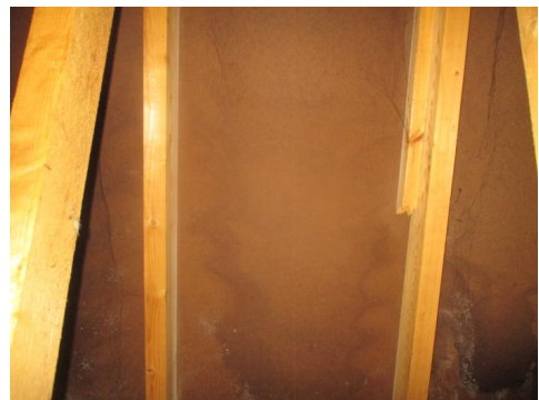
Fukt/kondensmerker på undertaket (nr: 42)
