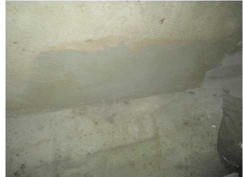
Noe mindre fuktvandring i nedre del av grunnmur i bod enhet 40.
