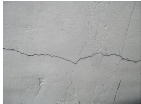
Sprekk ytterhjørne nr:40
