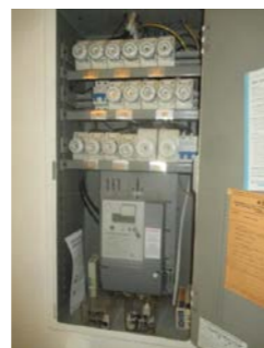
Sikringsskap for nr: 42 er plassert i gangen hovedetasjen.
