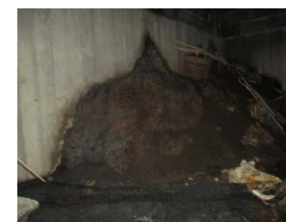
Noe innsig av fuktighet må forventes til tider.
