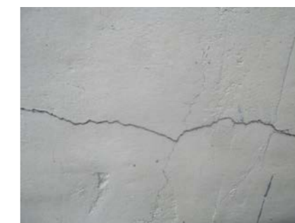
Sprekk ytterhjørne nr:40
