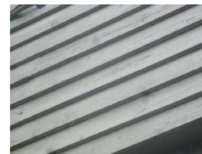
Noe soltørket og værslitt på de mest utsatte steder.
