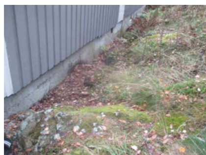
Fall mot grunnmur på baksiden av begge boenheter.
