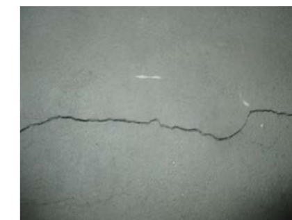
Synlig langsgående sprekke i bod i nr: 40.
