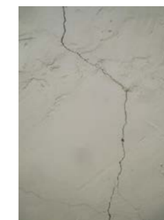
Sprekker ene ytterhjørne nr:40.
