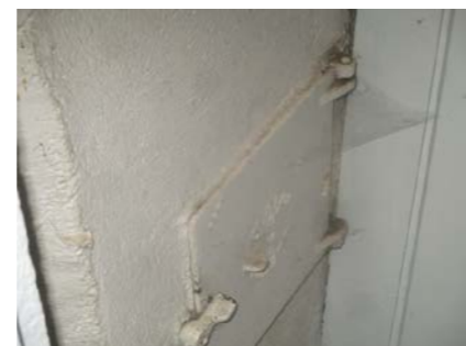
Sotluke i gangen under trapp i nummer 42.
