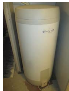
Bereder for nr: 42 er plassert på vaskerommet.
