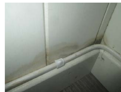
Noe fukt/kondensmerker på utfored vegg på soverom i enhet 42.
