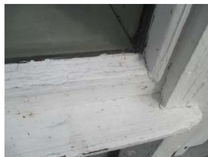
Slitasje på utvendig karm og ramme.
