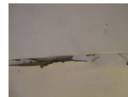
Skade himling i 42.
