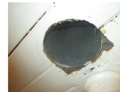
Luftekanal uten deksel.
