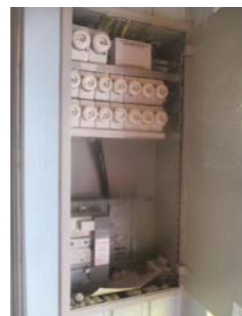
Sikringsskap for nr: 40 er plassert i vindfang.
