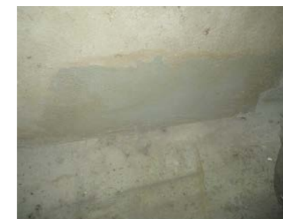
Noe mindre fuktvandring i nedre del av grunnmur i bod enhet 40.
