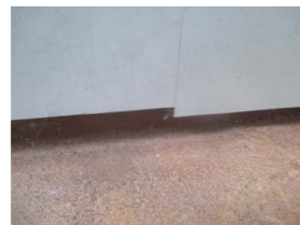
Våtromsplater er ikke fuktsikret i bunnen.
