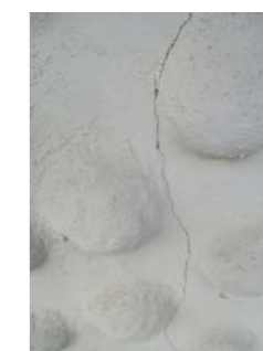
Mindre riss under enkelte vinduer.
