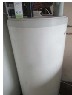
Bereder for nr: 40 er plassert på vaskerommet.
