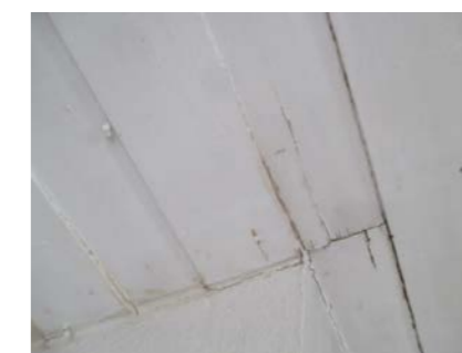
Lekkasjemerker i rundt pipe i 42.
