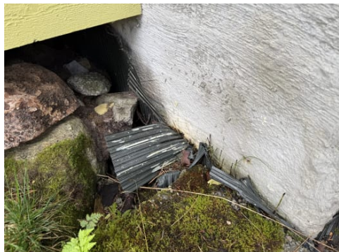
Grunnmursplast er stedvis mangelfullt avsluttet.
