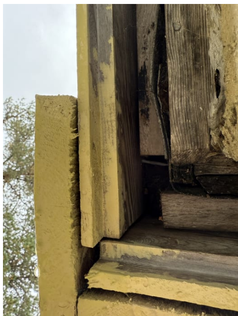
Det er registrert manglende musetetting i hjørner.
