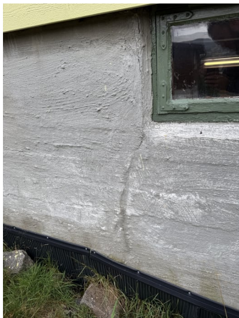
Det er registrert flere sprekker i grunnmuren.
