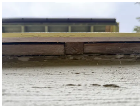
Det er liten luftespalte bak kledning.
