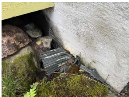
Grunnmursplast er stedvis mangelfullt avsluttet.
