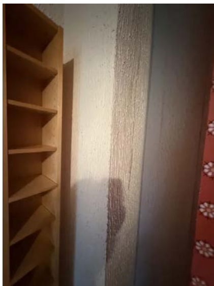
Det er registrert renn langs pipa.
