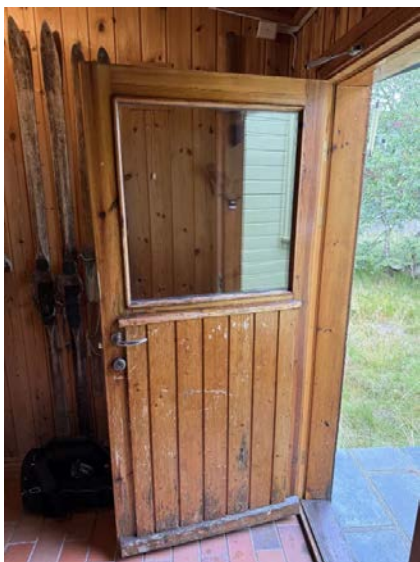
Ytterdør er av eldre årgang og bærer preg av slitasje.
