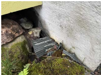
Grunnmursplast er stedvis mangelfullt avsluttet.
