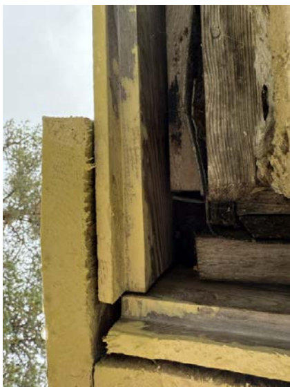
Det er registrert manglende musetetting i hjørner.
