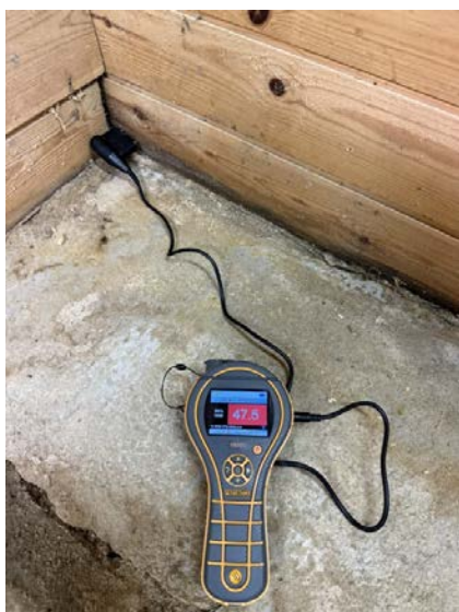
Det ble registrert stedvis høye verdier av fukt ved målinger.
