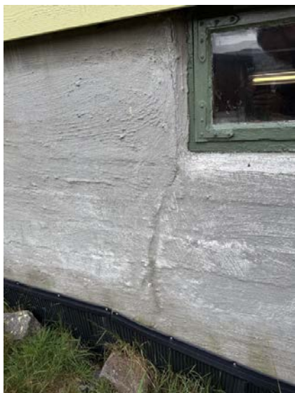
Det er registrert flere sprekker i grunnmuren.
