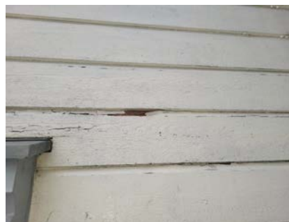
Sprekker og malingsavflassing på kledning.
