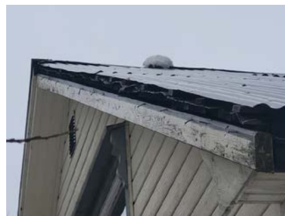
Vindskibord og beslag på hovedtaket er falt ned.
