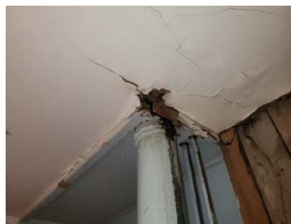
Skade i himling på bod i hovedetasjen.
