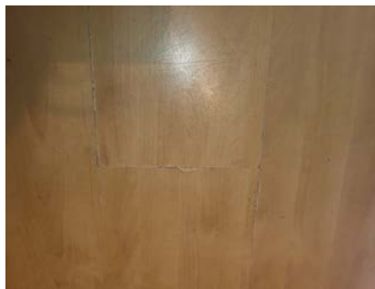
Skade på gulv i kjøkken.
