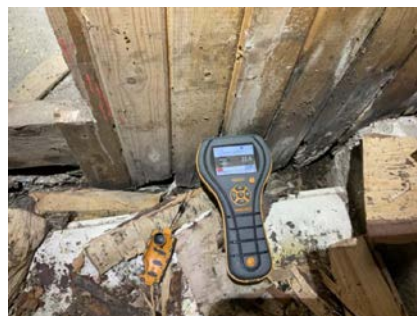
Råteskader på trepanel på vegg.
