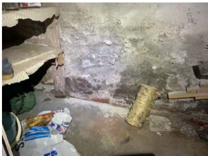
Saltutslag på murvegg i kjeller.
