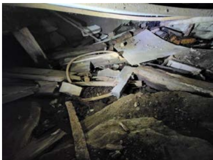
Råteskadet materialer under bjelkelag i kjeller.
