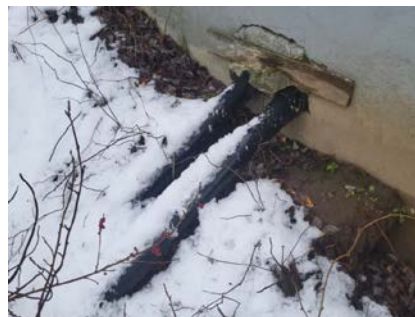
Avløpsrør ligger synlig på bakken ved grunnmur.
