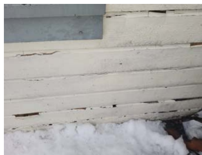
Stedvis råteskader i trepanel.
