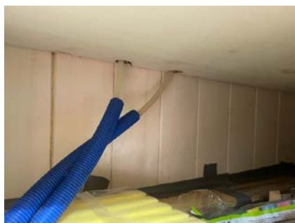
Varerør mangler tettemuffer
