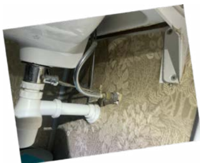
Avvik på rørgjennomføring i våtsone
