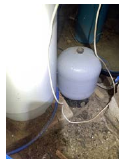
Bereder står på trekasse i ett veldig fuktutsatt miljø.
