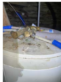
Drypper fra samlestock for vannrør.
