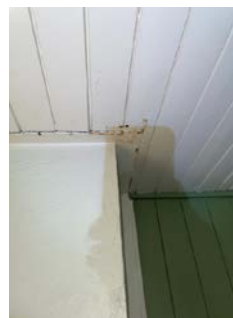
Antydning til sotvann ved gjennomføring.
