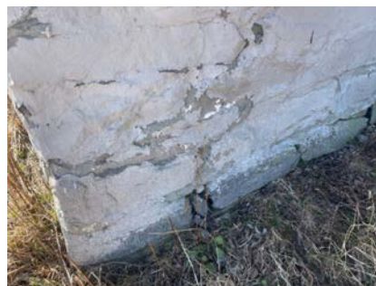
Eksempel på sprekkdannelser i mur.
