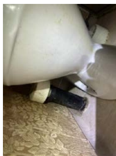
Avvik på rørgjennomføring i våtsone
