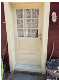
Hovedytterdør. Synlig slitasje og sår i overflater.
