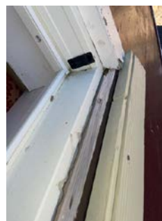
Ufaglig løsning på utvendig vannbrett.
