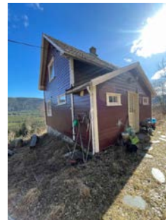
Lav høyde mellom bordkledning og terreng på tilbygget inngangsparti
