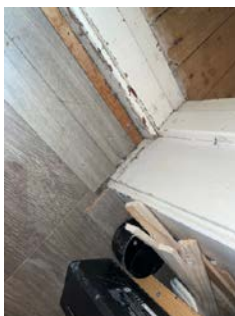
Ufaglig avslutning/innfesting av laminat i entré
