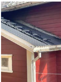
Mangler endelokk og skade i renne på hovedtak
