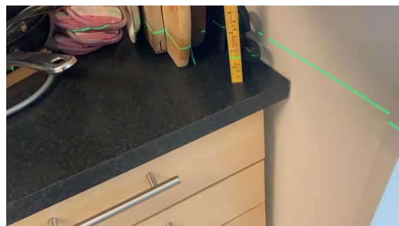
Målt skjevhet på innredning: 10mm.
