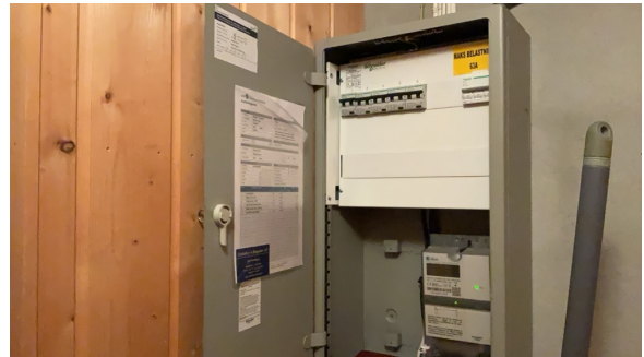
Sikringsskap plassert på bod.
