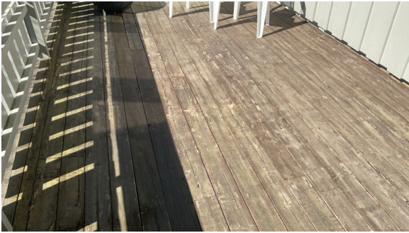
Slitasje på overflater.
