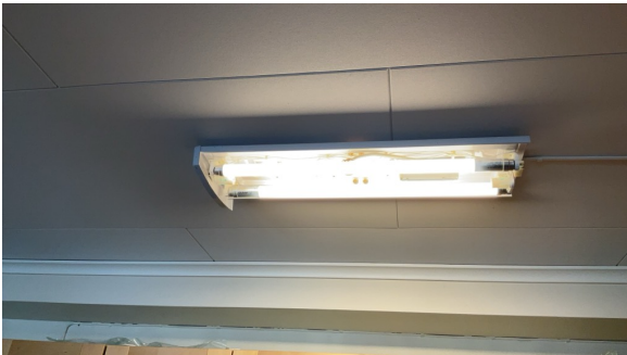
Armatyr på kjøkken mangler deksel.
