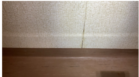
Tapetskjøter er ikke tette.
