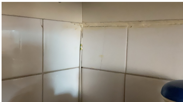
Sprekk i flis
