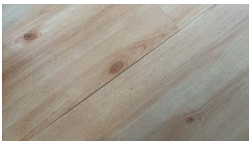
Laminat glipper opp i skjøter enkelte steder.
