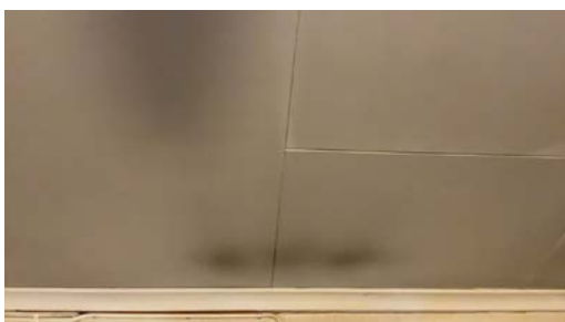
Misfarging i himling over stråleovn.
