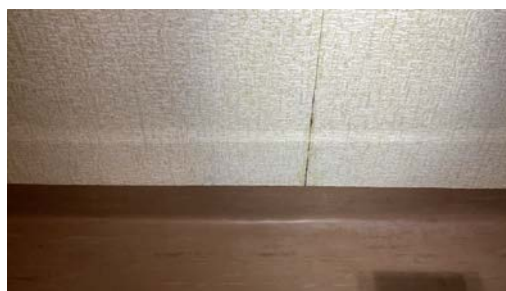
Tapetskjøter er ikke tette.
