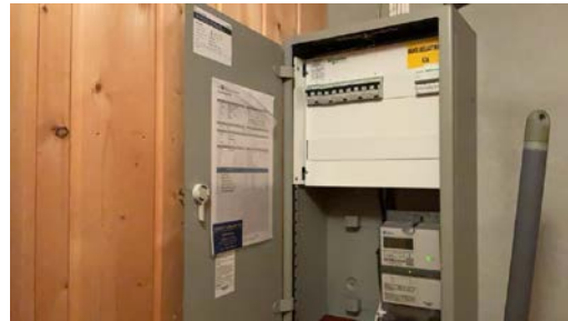
Sikringskap plassert på bod.
