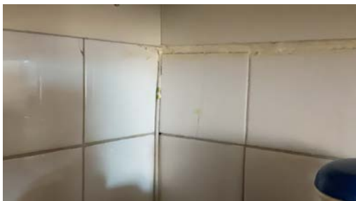
Sprekk i flis
