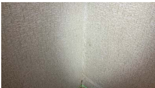
Tapet løsner i hjørner.
