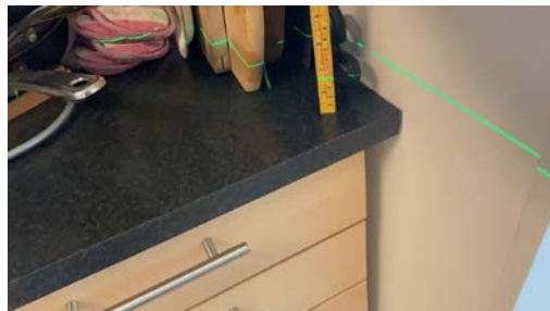
Målt skjevhet på innredning: 10mm.
