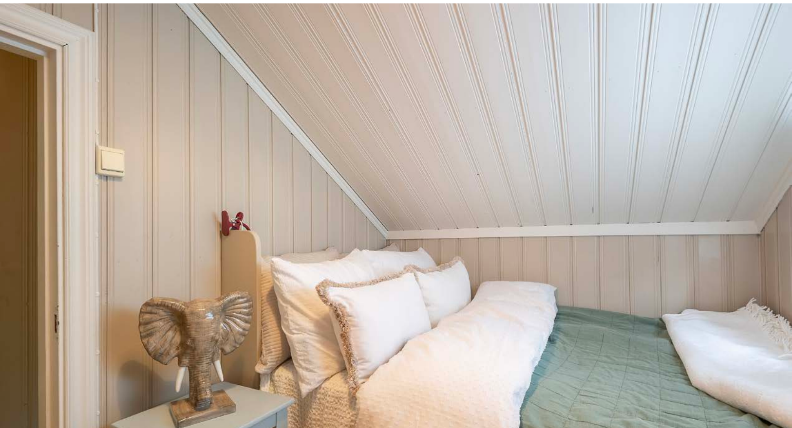
Innredet rom på loft, ikke byggemeldt.
