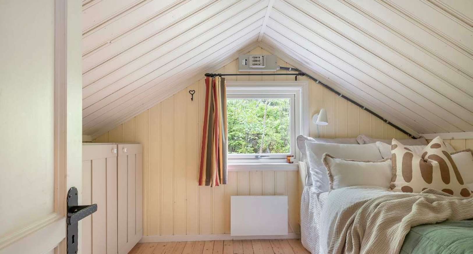
Rom på loft ikke byggemeldt.
