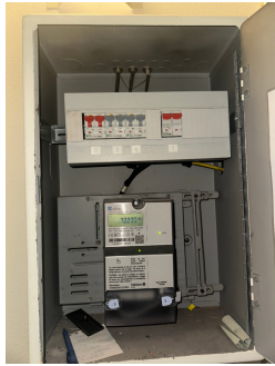
Sikringskap med automatsikringer.
