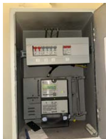
Sikringskap med automatsikringer.
