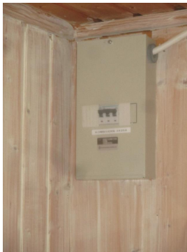
Hovedinntaket bpå ene soverommet.
