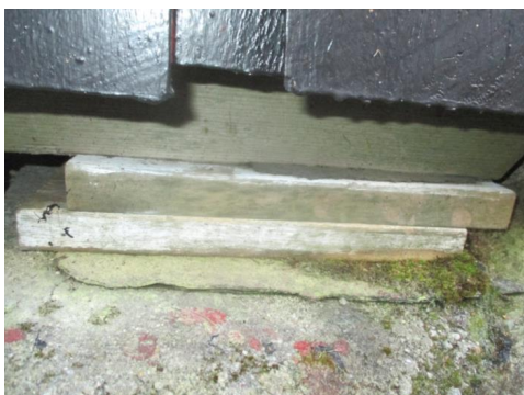
Lav høyde ved tilbygget i bakkant.
