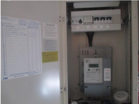
Sikringskapet er plassert i gangen.
