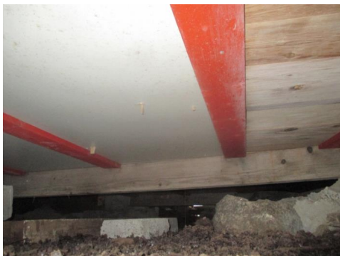
Noe løse masser enkelte steder.
