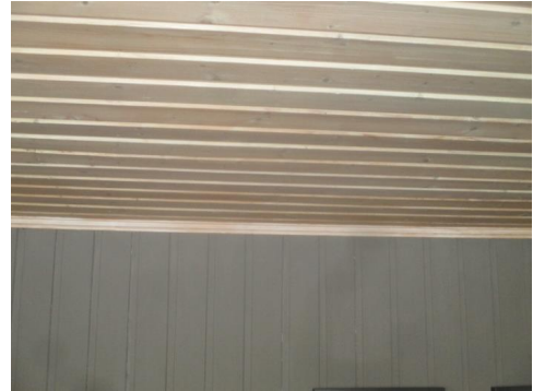
Noe nedbøyning av himling i opprinnelig del.
