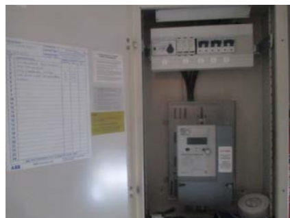
Sikringskapet er plassert i gangen.
