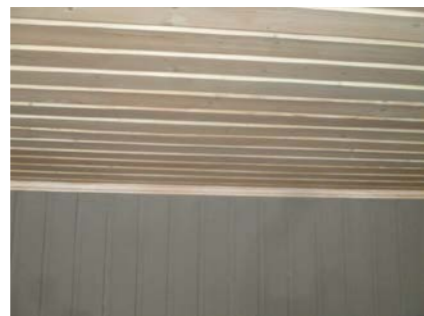
Noe nedbøyning av himling i opprinnelig del.
