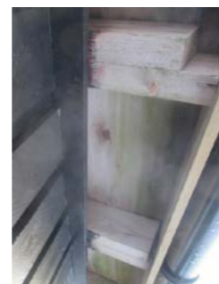
Del av gesimsen på baksiden av hytta er ikke ferdigstilt.
