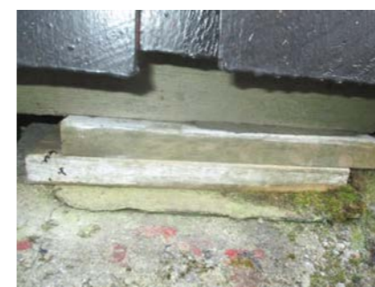
Lav høyde ved tilbygget i bakkant.
