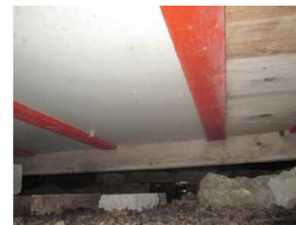
Noe løse masser enkelte steder.
