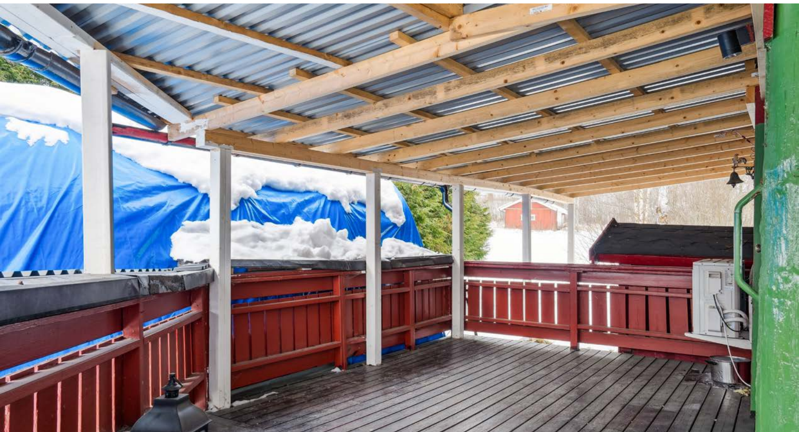
Terrassen har har omfattende skjevheter, så det må påregnes utbedringer.
