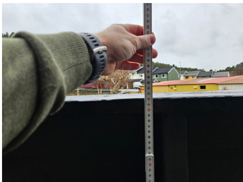
Rekkverk målt til 93 cm.
