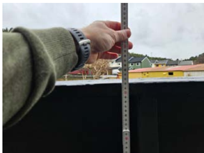
Rekkverk målt til 93 cm.
