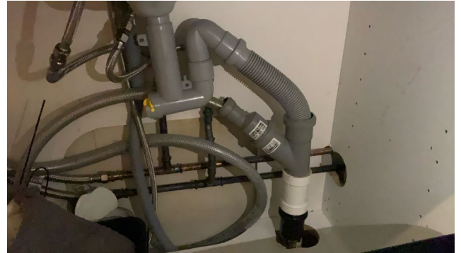
Utett i overganger på avløpsledninger.
