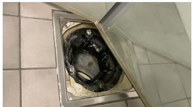
Plastsluk med eldre membran under klemring. Ny slukmansjett er ikke lagt i klem under klemring.
