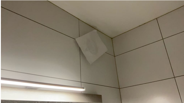
Ark henger på avtrekksventil.
