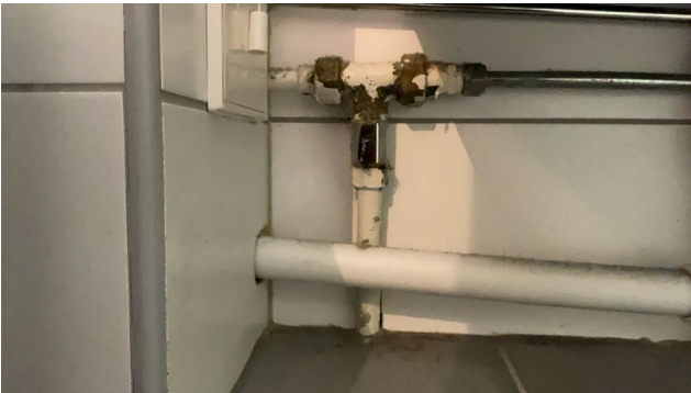
Vannledning inn i leiligheten.
