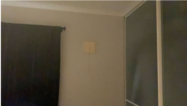
lufteventil på soverom.
