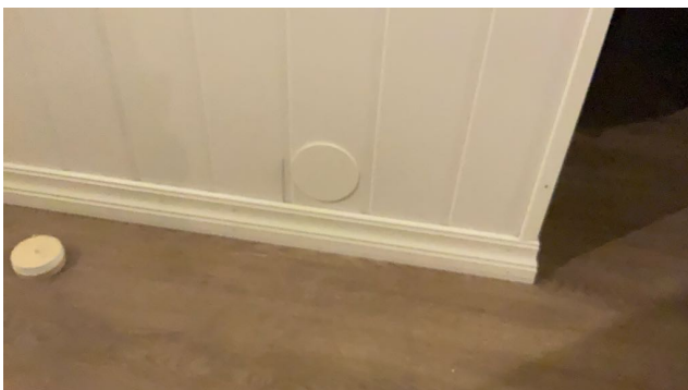
Hull forsvarlig plombert.
