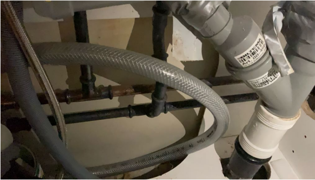
Eldre vannrør under kjøkkenbenk.
