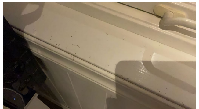
Småskader på utforing list i vindu på kjøkken.
