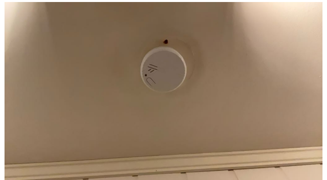
Røykvarsler montert i gang utenfor soverom.
