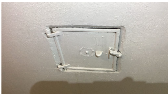
Utett sotluke må utbedres
