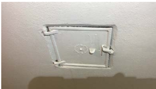
Utett sotluke må utbedres
