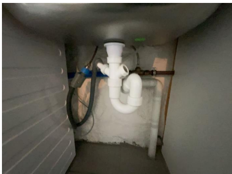
Del av rør til avløp.
