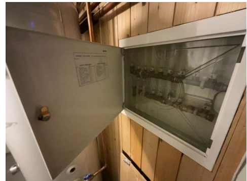
Skap til rør i rør system.
