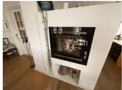
Montert ovn i stue/kjøkken.
