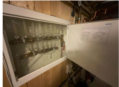
Skap til rør i rør system.
