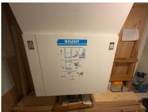
Aggregat til balansert ventilasjon.
