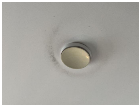
Eksempel på montert ventil i tak.
