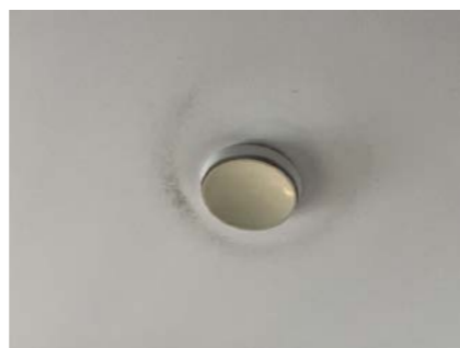
Eksempel på montert ventil i tak.
