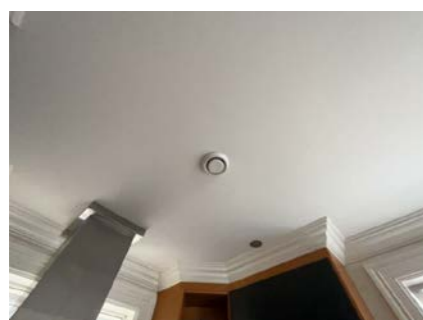
Eksempel på montert ventil i tak.
