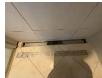
Sluk i gulv. 2 ETASJE > HOVEDBAD
