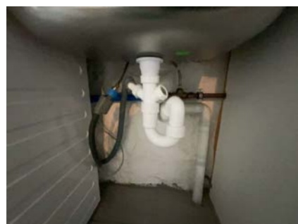
Del av rør til avløp.
