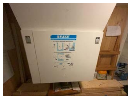
Aggregat til balansert ventilasjon.
