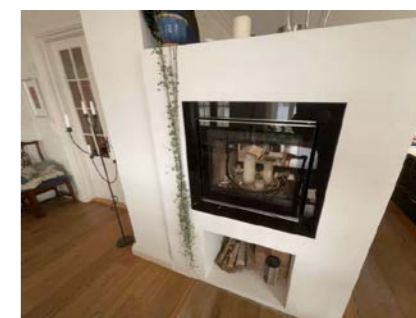
Montert ovn i stue/kjøkken.
