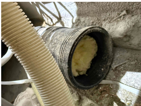
Bidet viser avløpsrøret under kjøkkenet er ikke forsvarlig blendet.
