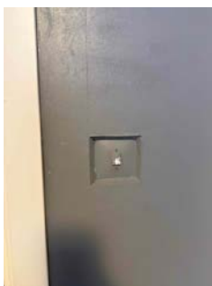
Bildet viser ikke fagmessig utførelse av plate rundt lysbryter.
