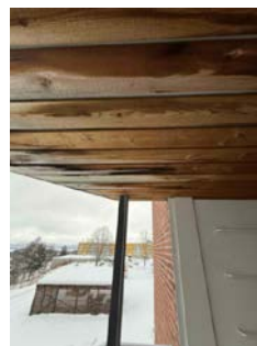
Bildet viser fuktskjolder i himlingen på balkongen.
