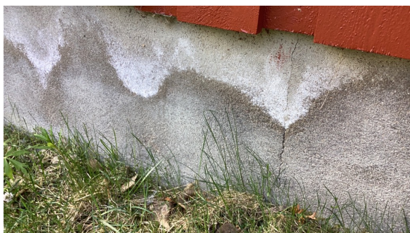
Saltutslag på grunnmur.
