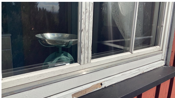
Eksempel på slitasje.
