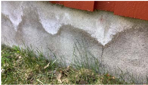
Saltutslag på grunnmur.
