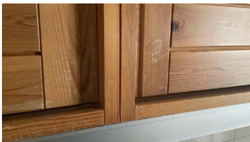
Eksempel på slitasje.
