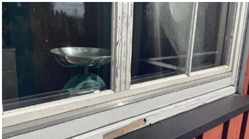
Eksempel på slitasje.
