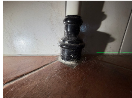
Eksempel tegn til utett rørgjennomføring i gulv.
