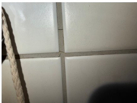
Eksempel på riss i flisfuge i våtsonen.
