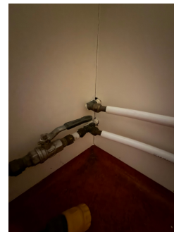
Eksempel på utette rørgjennomføringer.
