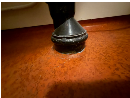
Eksempel på utett rørgjennomføring i vinylbelegget.
