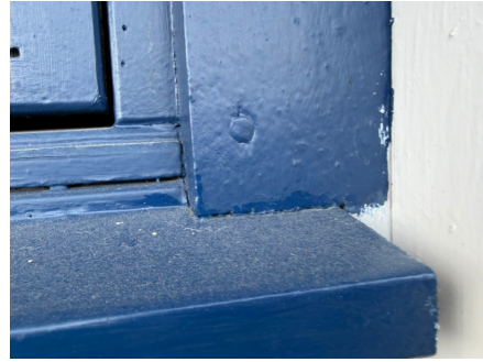
Utvendig listing støter mot vannbrettbeslaget.
