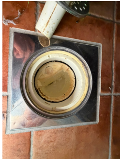
Det er plastsluk plassert under badekaret.
