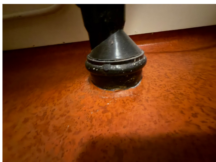
Eksempel på utett rørgjennomføring i vinylbelegget.
