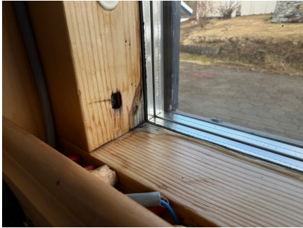
Eksempel på tegn til kondensering innvendig.
