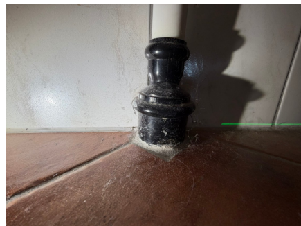
Eksempel tegn til utett rørgjennomføring i gulv.
