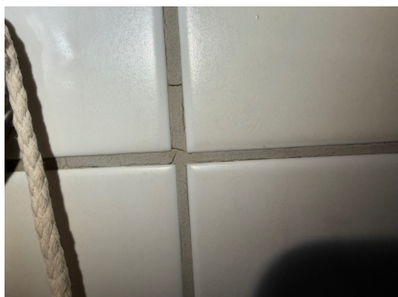
Eksempel på riss i flisfuge i våtsonen.
