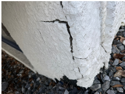
Eksempel på sprekkdannelser i murpuss.
