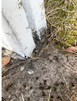
Eksempel på værslitt overflatebehandling.
