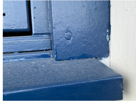
Utvendig listing støter mot vannbrettbeslaget.
