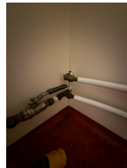
Eksempel på utette rørgjennomføringer.
