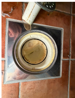
Det er plastsluk plassert under badekaret.
