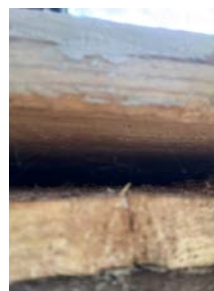
Deler av boligen mangler musesperre i nedkant kledning.
