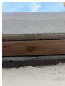
Deler av boligen mangler lufting bak kledningen.
