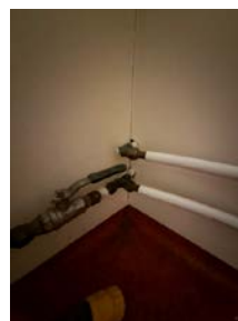
Eksempel på utette rørgjennomføringer.
