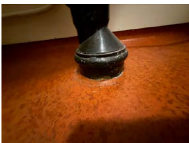
Eksempel på utett rørgjennomføring i vinylbelegget.
