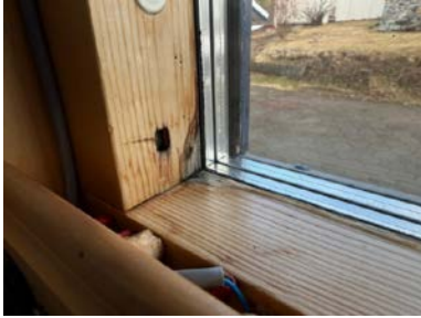
Eksempel på tegn til kondensering innvendig.
