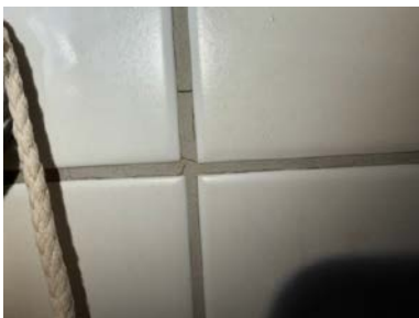
Eksempel på riss i flisfuge i våtsonen.
