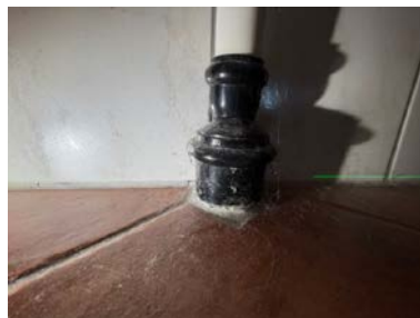
Eksempel tegn til utett rørgjennomføring i gulv.
