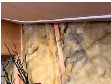
Eksempel på hvor det mangler dampsperre og mørke partier i isolasjonen som antyder luftlekkasje.
