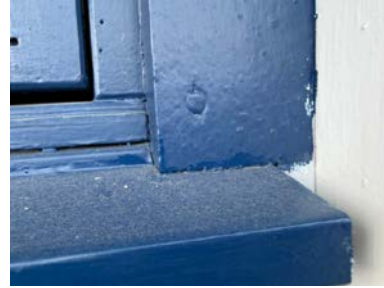
Utvendig listing støter mot vannbrettbeslaget.
