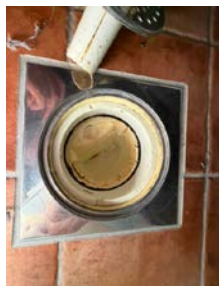
Det er plastsluk plassert under badekaret.
