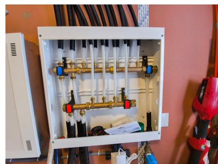
Fordelerskap i teknisk bod.
