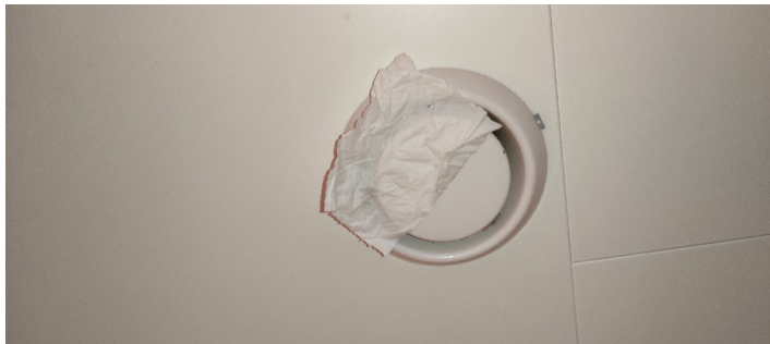
Funksjonstest av avtrekk.
