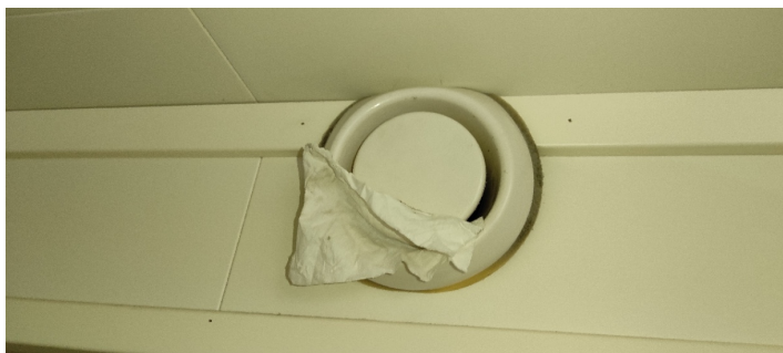
Funksjonstest av avtrekk.
