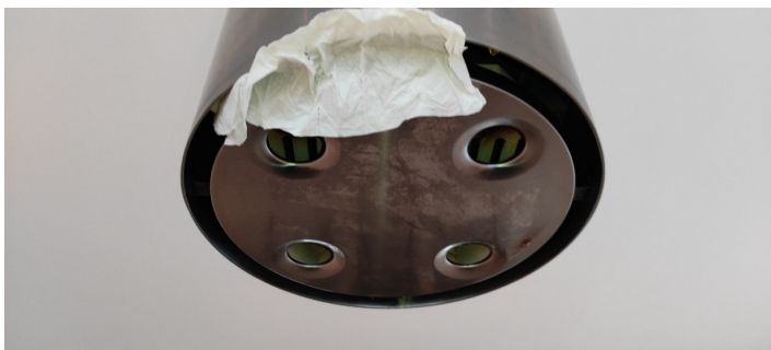
Funksjonstest av ventilator.
