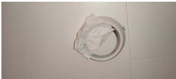
Funksjonstest av avtrekk.
