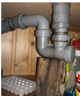
Lekkasje fra avløpsrør/vannlås.
