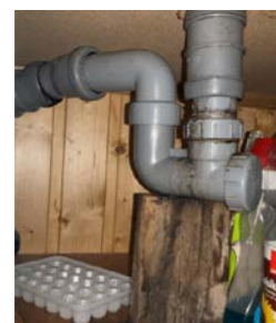
Lekkasje fra avløpsrør/vannlås.
