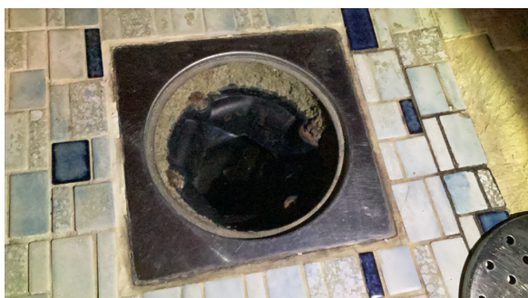
Sluk av plast. Det er ikke tegn til membran.
