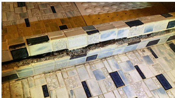
Oppkant har sprukket.
