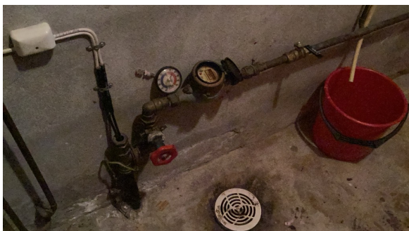
Stoppekran og vannmåler på teknisk rom.
