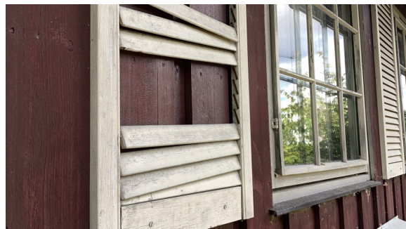
Treverk løsner fra sjalusirister.
