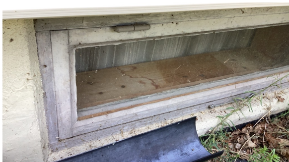
Eksempel på slitasje.
