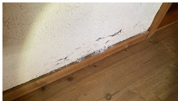
Saltutslag på vegg i peisstue
