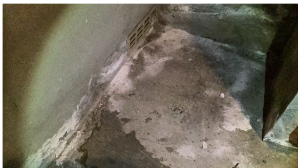
Saltutslag på teknisk rom.
