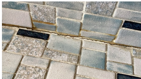
Det sprekker opp i overgang
