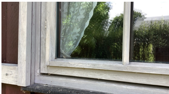
Eksempel på slitasje.
