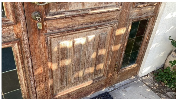
Slitasje på entredør.
