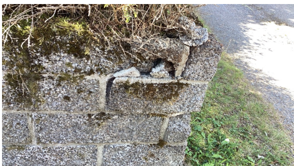
Oppsprekking i hjørne på støttemur av lettklinker.
