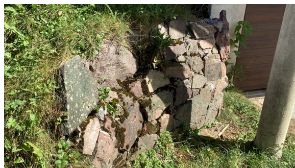
Det sprekker opp i fuger på murer av naturstein.
