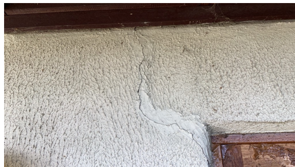
Eksempel på sprekk i mur.
