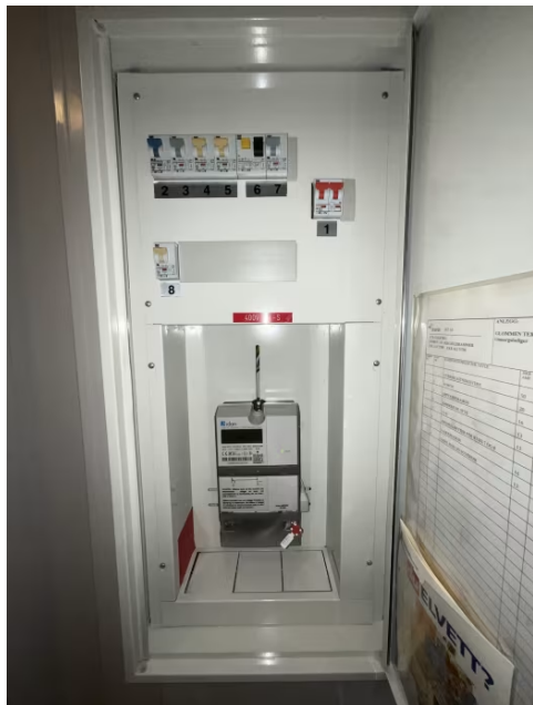
Viser sikringskap plassert i skyvedørgarderobe i gang.
