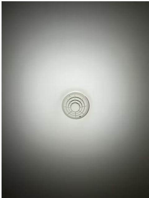
Brannvarsling plassert i gang, soverom og stue.
