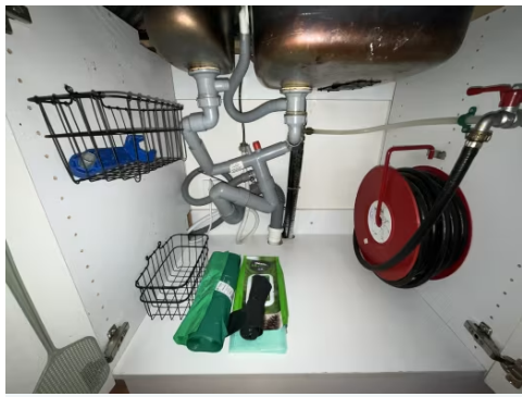
Viser vann og avløpsinstallasjoner under kum og brannslange.
