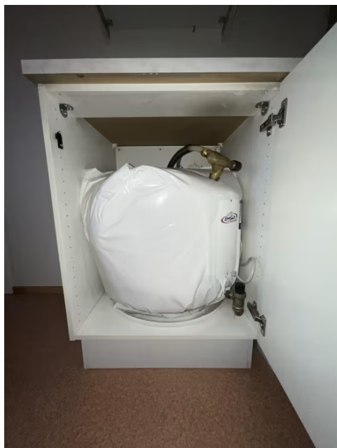
Viser bereder plassert i skap i stue.
