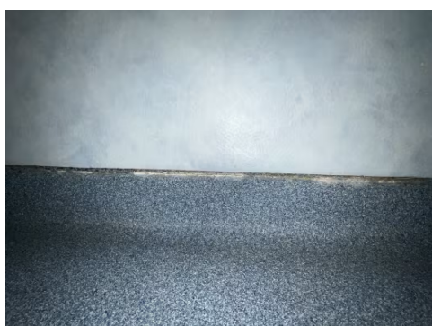
Det registreres løse skjøter, sprekker og buling på vinyl i våtsone med fare for fuktskade.
