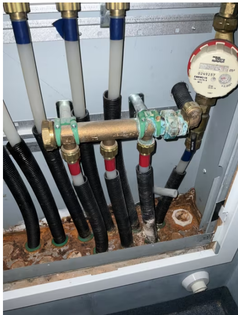
Det registreres rust, irr og drypplekkasje fra kobling i fordelerskap.
