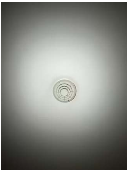
Brannvarsling plassert i gang, soverom og stue.
