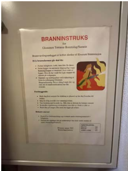
Viser branninstruks på sikringssskap.
