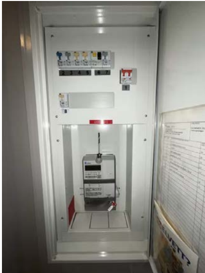
Viser sikringskap plassert i skyvedørgarderobe i gang.
