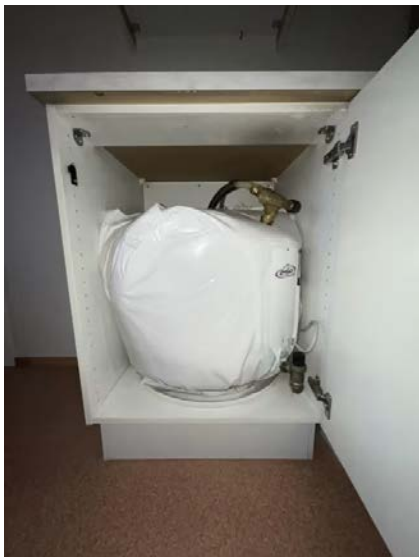
Viser bereder plassert i skap i stue.
