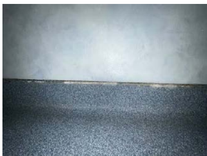
Det registreres løse skjøter, sprekker og buling på vinyl i våtsone med fare for fuktskade.
