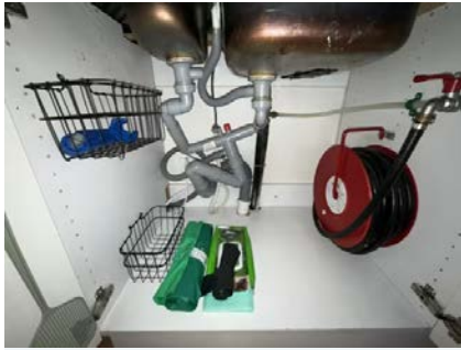
Viser vann og avløpsinstallasjoner under kum og brannslange.
