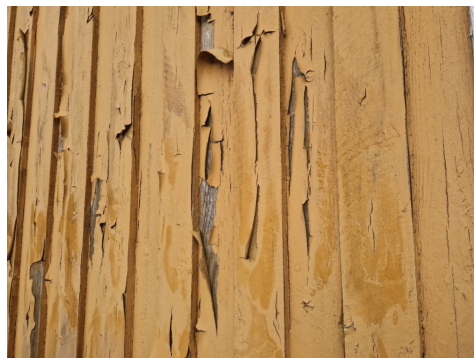
Råteskader i trepanel.
