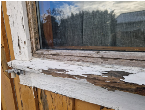
Råteskader i trevirke
