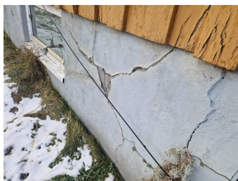
Sprekker i grunnmur.
