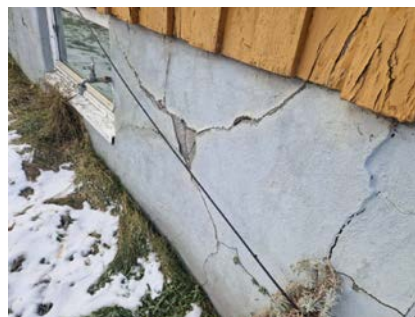
Sprekker i grunnmur.
