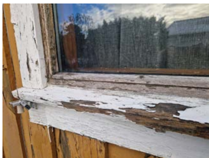
Råteskader i trevirke
