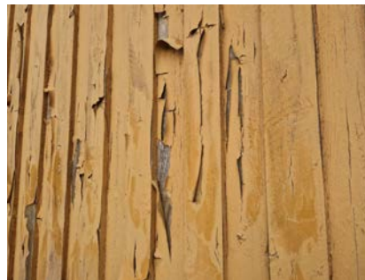
Råteskader i trepanel.
